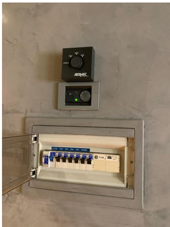
Termostato e quadro elettrico
