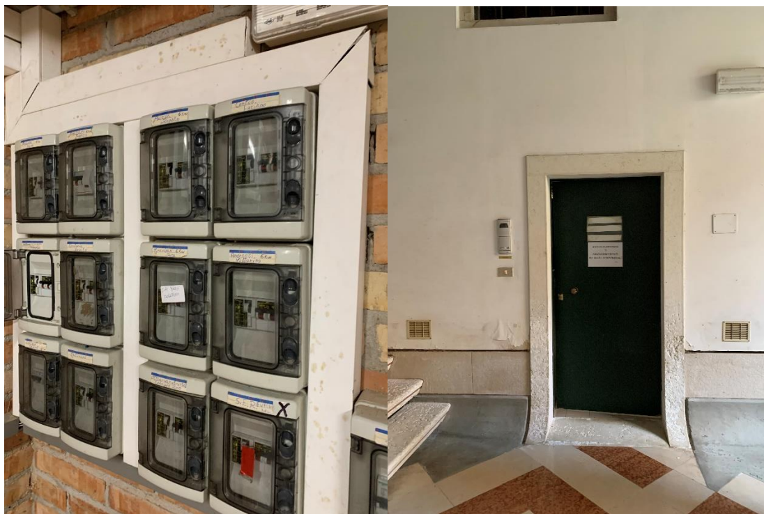
Locale contatori ENEL
