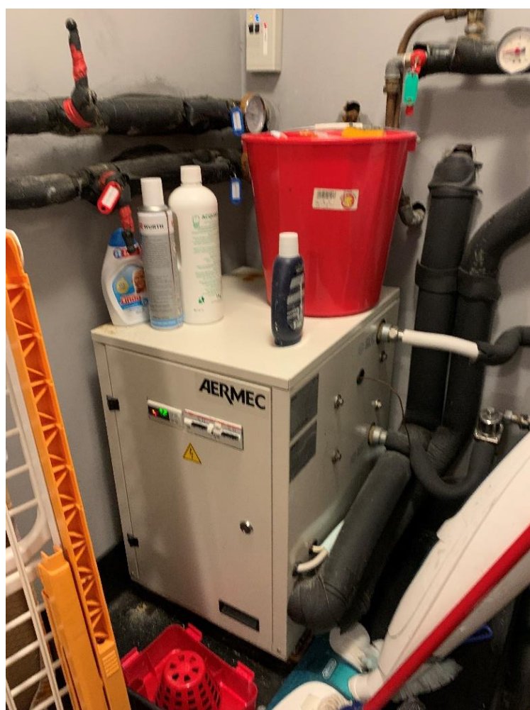
Pompa di calore Aermec Venice20 nel ripostiglio
