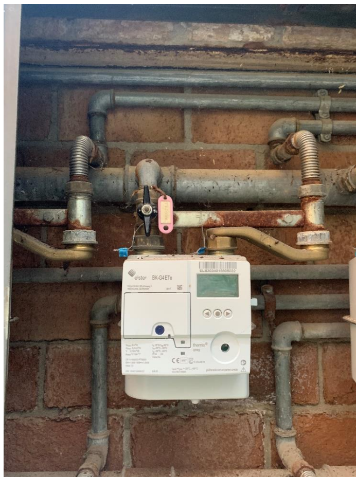
Contatore gas esterno posto dentro armadio nella corte comune
