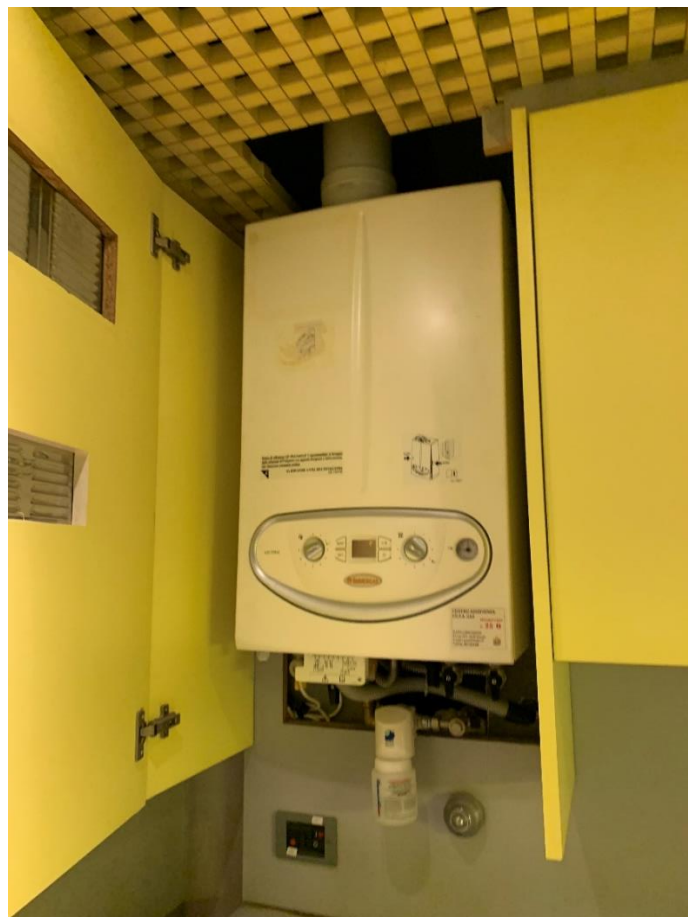
Dettaglio caldaia nel locale cucina
